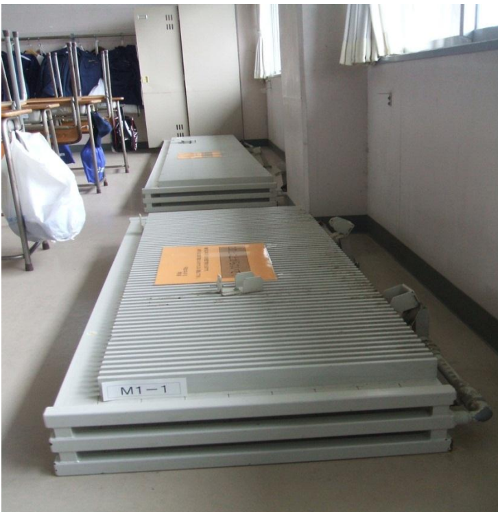
② 教室パネルヒーター
