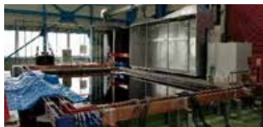
電解研磨槽(新設)
