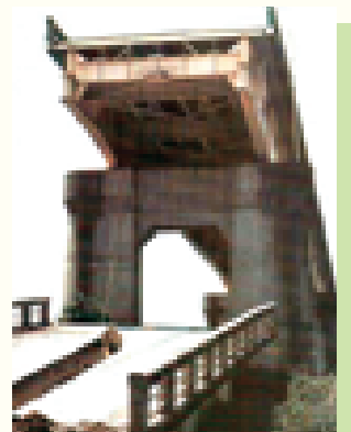
昭和53年の宮城県沖地震による落橋
