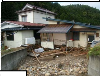
P1: 流出土砂による家屋一部損壊
