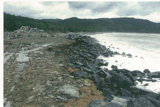
捨石護岸工の被災状況(駐車場部)
