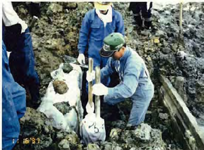
底樋の閉塞状況(ゲート施設が無く危険な状態)
