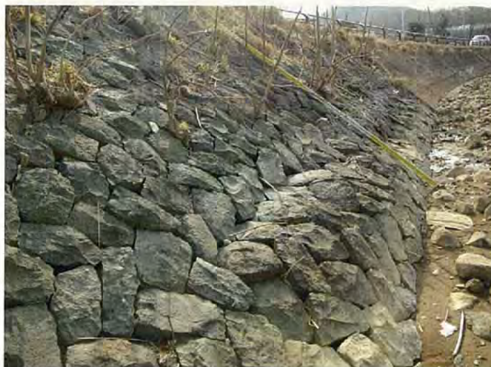
ため池護岸状況(はらみ, 崩落が見られる)
