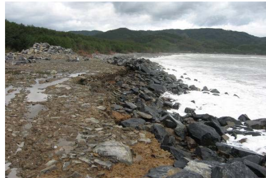
捨石護岸工の被災状況(駐車場部)
