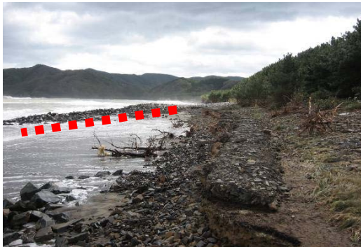
捨石護岸工の被災状況(北上川河口部側)
