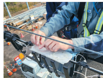
光ケーブルなど、髪の毛ほどの細い線を収納する様子。決められた形で収めるには特別なテクニックを要する。
