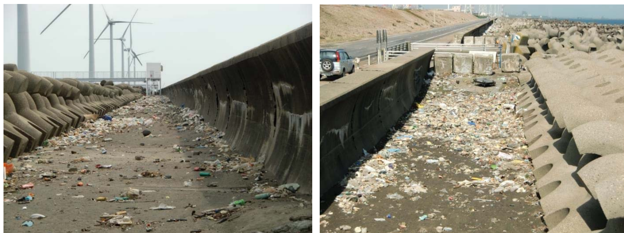
東日本大震災直後のウィンド・パワーかみす第1洋上風力発電所
