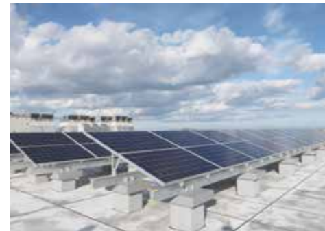
屋上に設置された太陽光発電設備
