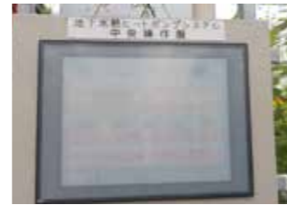
温度、日射量を制御する中央操作盤
