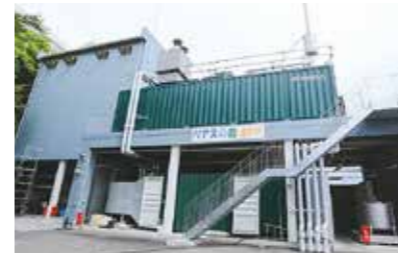
ガス化プラント
