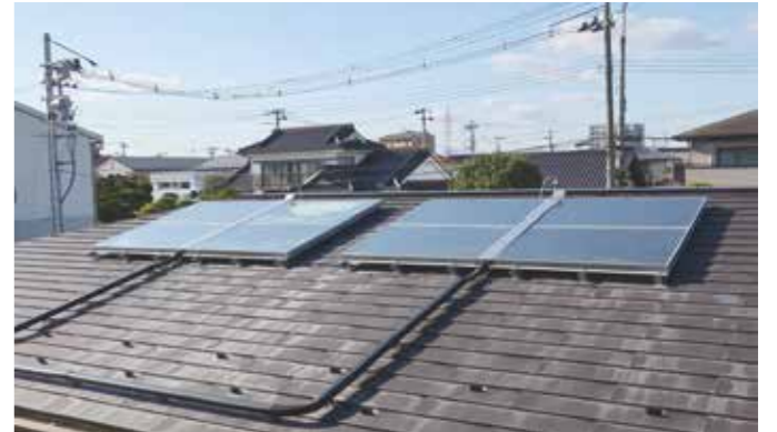
施設屋上に設置されている太陽熱集熱器
