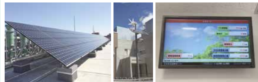
施設には太陽光パネルの他、太陽光・風力ハイブリッド街路灯、電力表示パネルも設置されています。
