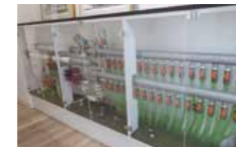
地中熱ヒートポンプシステムの一部
