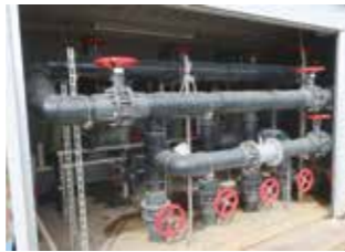
地下水をくみ上げるポンプ室 取水井と還元井は、 Φ150 100m×6本
