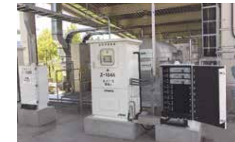
みやぎ生協の物流センターに設置された実証設備
