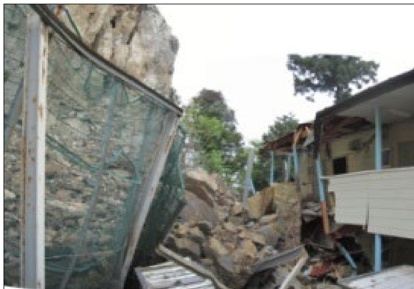
東北地方太平洋沖地震により発生したがけ崩れ (石巻市鹿妻 地内)
