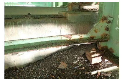
土砂堆積状況
