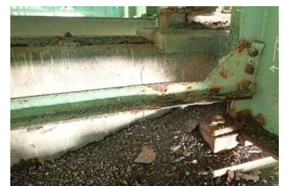
土砂堆積状況
