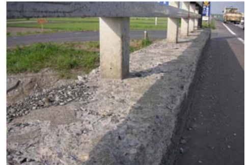
遊離石灰 (凍害)
