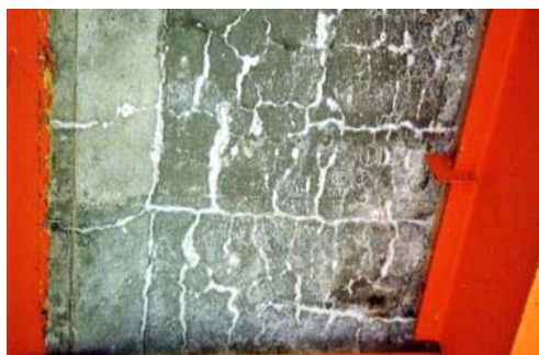
床版ひび割れ
