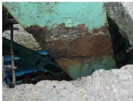
コンクリート埋込み部の破断
