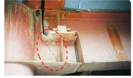
ゲルバー部の亀裂
