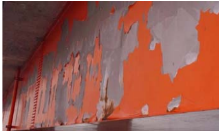
防食機能の劣化
