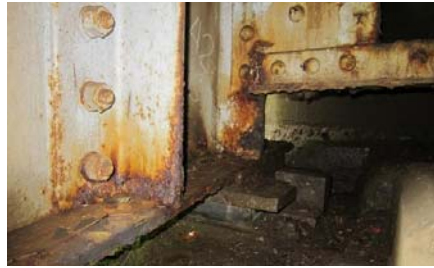
桁端部の腐食
