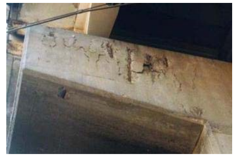
剥離鉄筋露出
