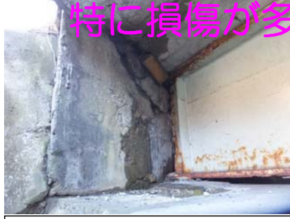
胸壁にひび割れあり、背面の陥没の危険性あり。
