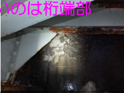
胸壁が剥落し壁厚が減少。背面の陥没の危険性あり。
