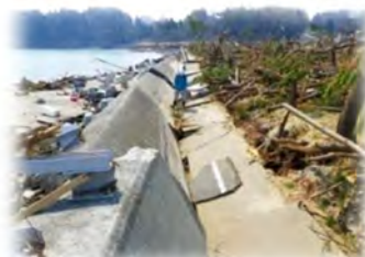
被災した防潮堤と海岸林
