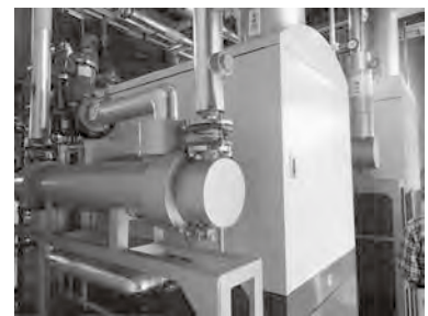
木質バイオマスボイラー本体 (100kwと200kwの2基)
