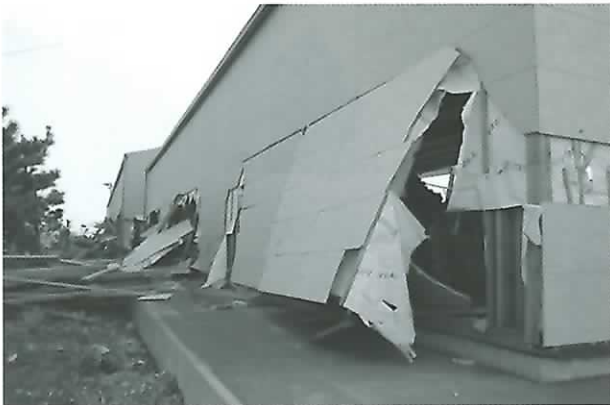
津波が突き抜けた工場
