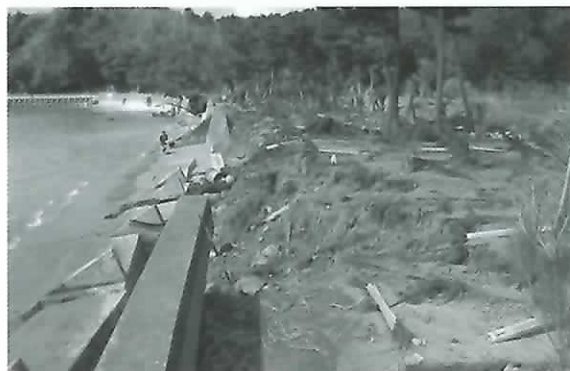
津波により倒伏した防潮堤(石巻市)
