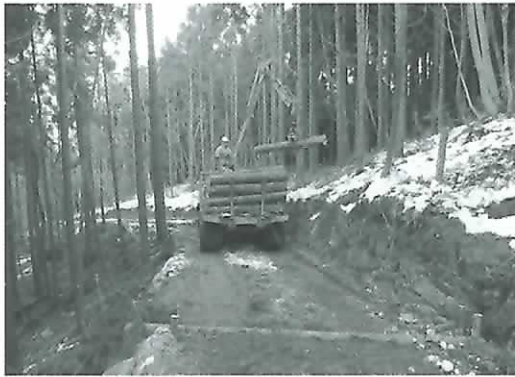
モデル道でのフォワードによる運材作業状況 (木製横断工(手前)、切土法面は1.5m以内の直切り)
