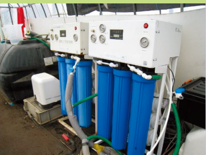
図13 逆浸透膜装置(亶理町、日浄水量約3m 3 )
