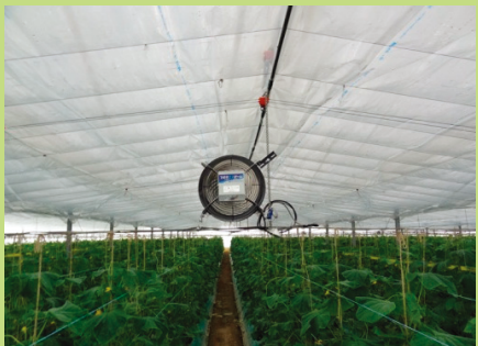
図3 循環扇を設置した現地実証温室
