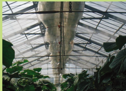
図2 高圧細霧の噴霧状況
