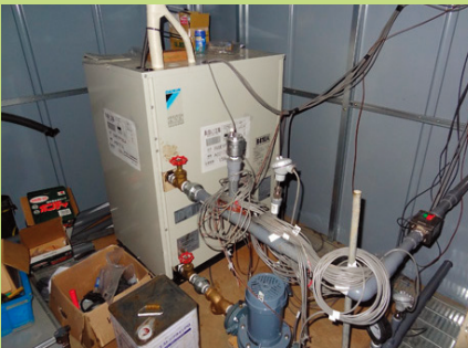
図5 地中熱ヒートポンプ室外機
