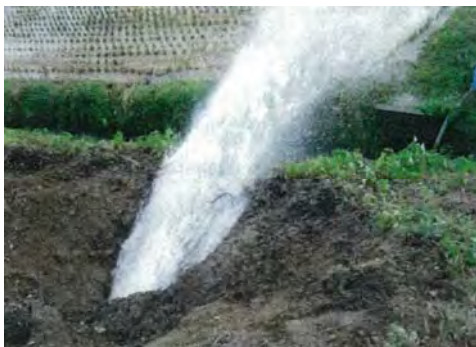
写真-1 角田市神次郎地内の漏水事故の状況
