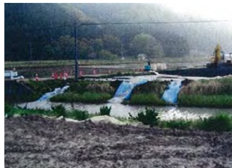
写真-2 岩沼市南長谷地内の漏水事故の状況
