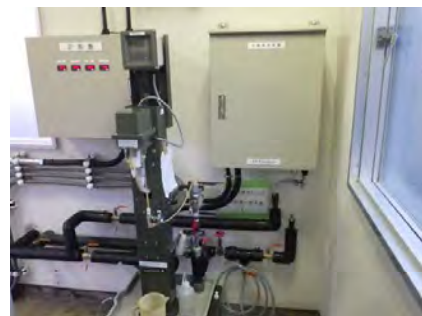
末端受水水質監視装置点検状況
