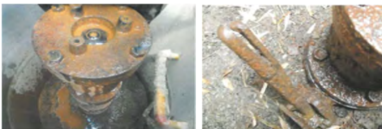
空気弁等の劣化や不具合状況(例)
