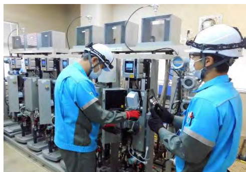
設備点検状況
