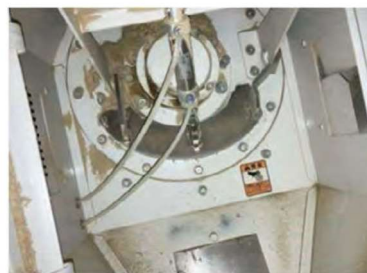
⑦脱ボウ機 処理胴底 上部点検カバーと下部清 掃カバーを開けて清掃
