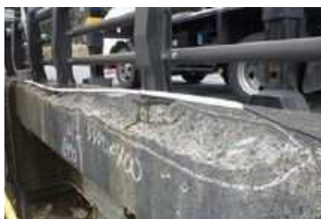
地覆の剥離・鉄筋露出
