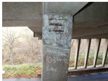
柱の剥離・鉄筋露出
