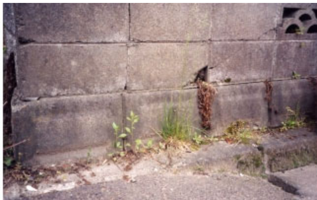
上写真)危険なブロック塀の例(下部にひび割れがあり、ずれも生じている)
