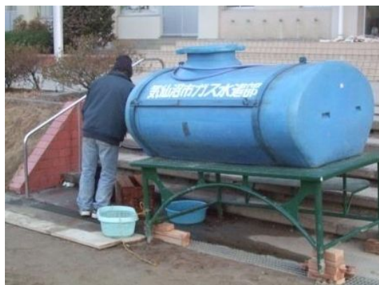
【校庭に設置した給水タンク】
