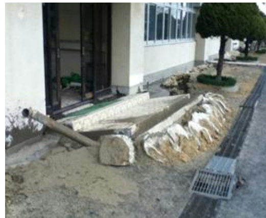
液状化で地盤沈下した職員玄関
