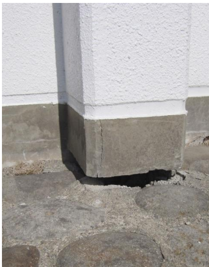
食堂外壁の被害の様子
