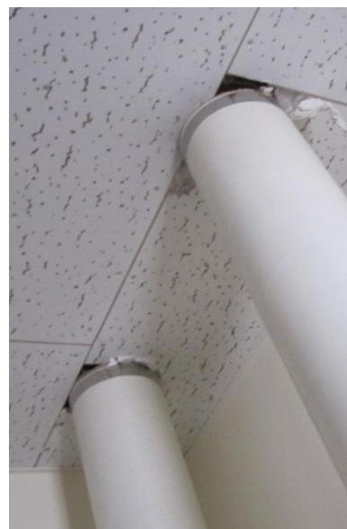
天井部のボイラー配管の様子
