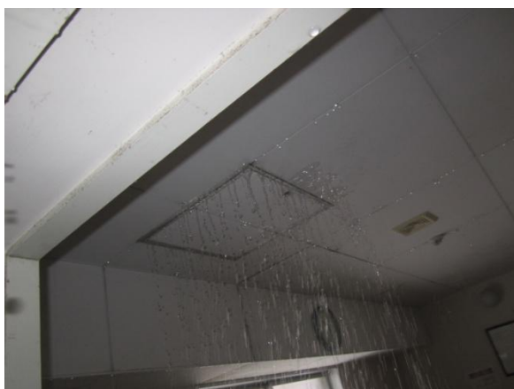
第3浴室天井の漏水の状況
