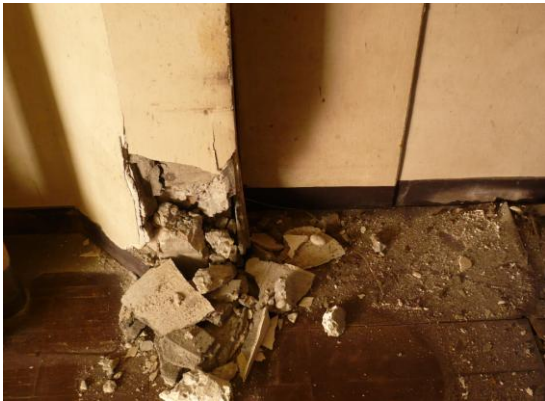
柱に亀裂が入った本館1階
