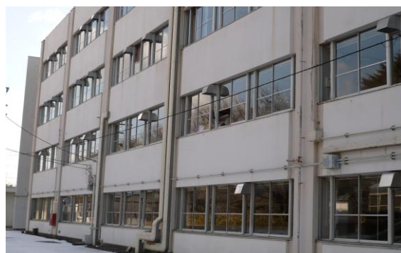
ガラスが落下した本館
