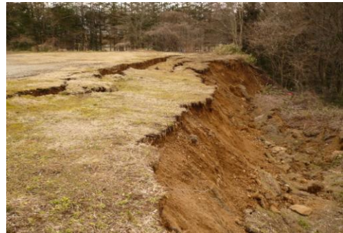
地滑りが発生した駐車場奥の様子
