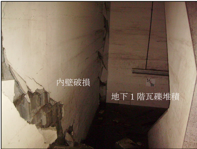
被災状況（H23.3.22 撮影）
