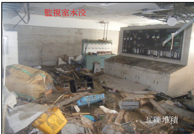
被災状況 (H23.3.17 撮影)
