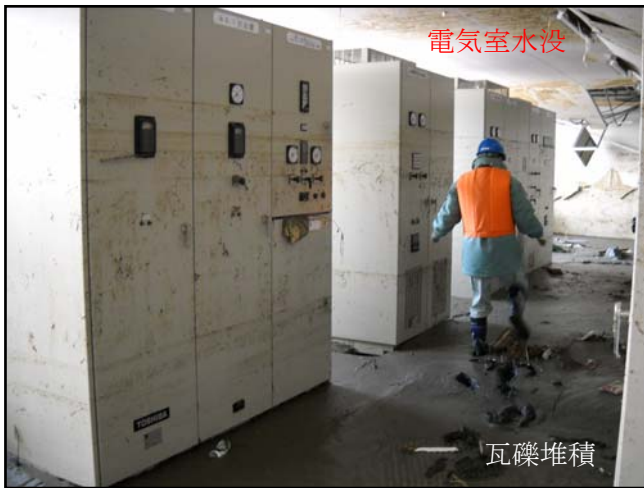
被災状況 (H23.3.17 撮影)
