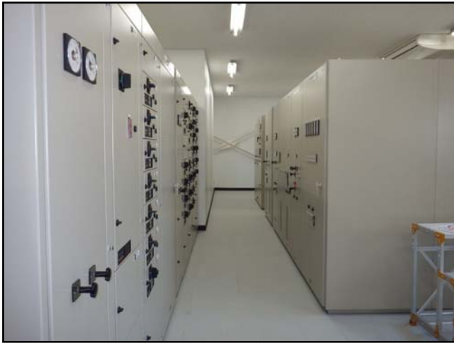
配電盤等（電気室内）
