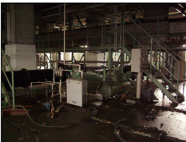
被災状況（H23.3.22撮影）
