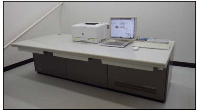
監視装置（監視室内）
