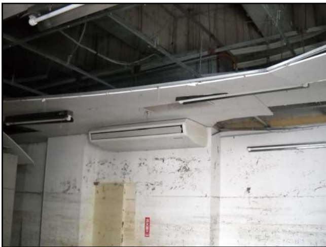
被災状況（H23.3.17撮影）
