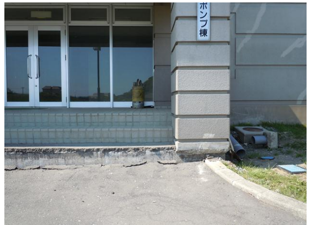
石巻浄化センター内地盤沈下 沈砂池ポンプ棟前
