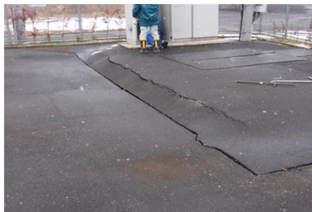
河南ポンプ場被災状況
