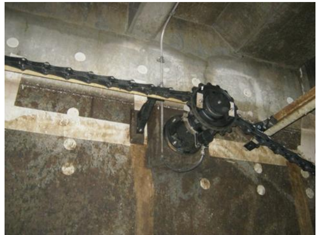
脱落した最終沈殿池掻寄機チェーン
