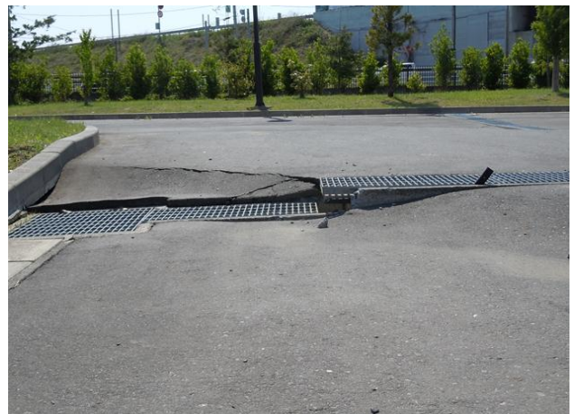
石巻浄化センター内地盤沈下
