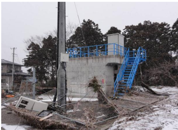
鳴瀬ポンプ場被災状況
