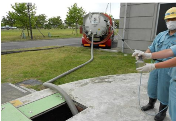
重力濃縮槽への石巻東部浄化センター汚泥排出と芳香剤散布状況
