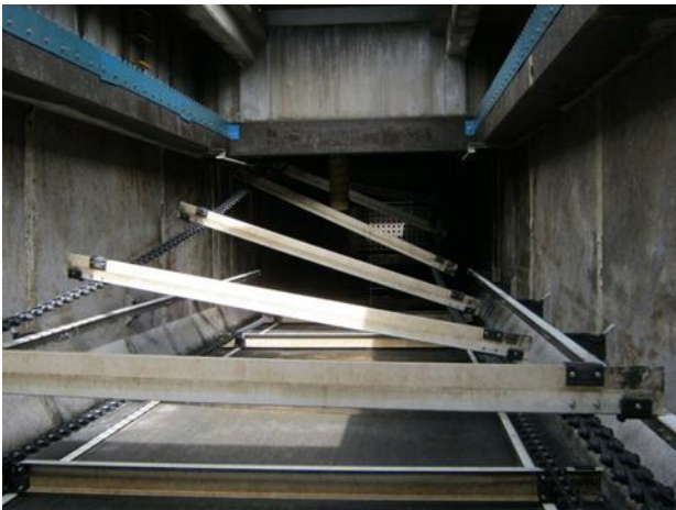
脱落した最終沈殿池の掻寄機
