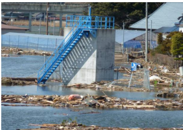
鳴瀬川右岸（2-101 特殊人孔）浸水状況
