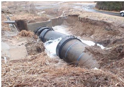
高区系送水管 伸縮可撓管の離脱
