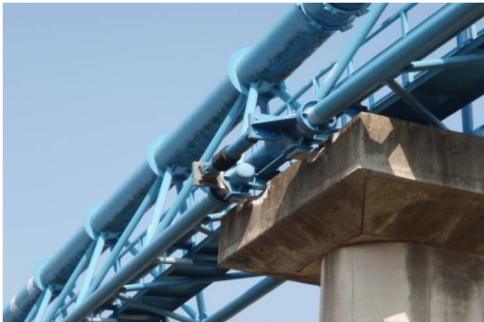
七北田川第2水管橋(被災状況)
