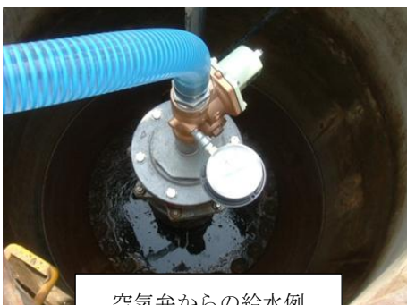
空気弁からの給水例
