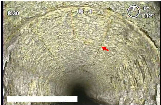
図1 既設下水道管内の腐食劣化状況 ・内部が腐食劣化により鉄筋の露出も確認できる
