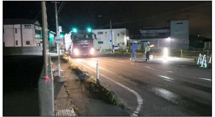
図2 市街地内の夜間施工状況 ・国道は市街地を通り、交通量も多い
