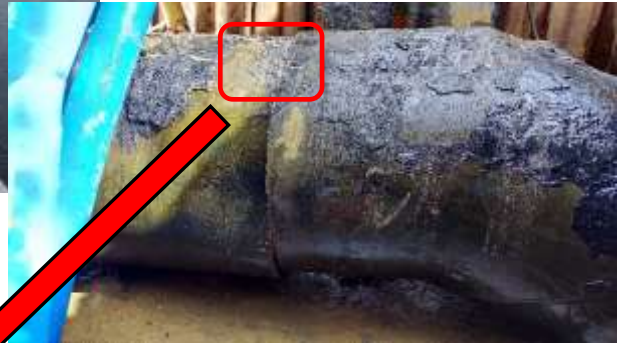
マリゲート塩釜漏水箇所 配水管破断
