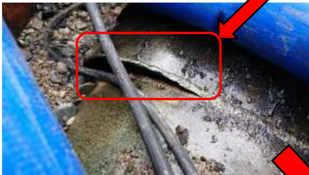
マリゲート塩釜漏水箇所 配水管破断（拡大）
