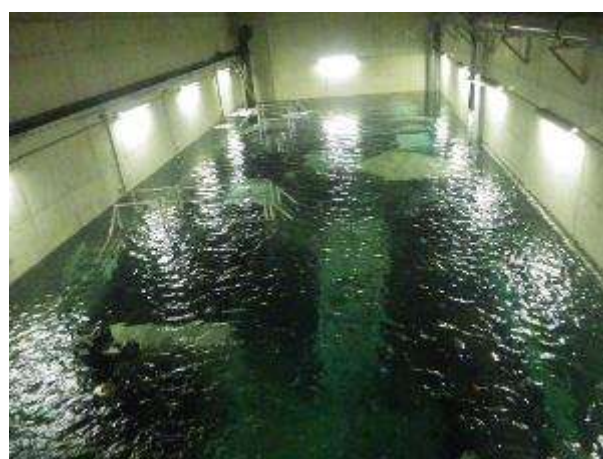
高区調整池流入流量計室機器水没状況
