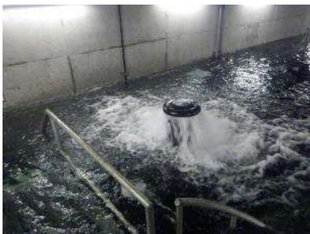
高区調整池空気弁からの漏水状況
