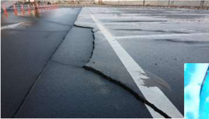
管路上で発生した地盤隆起
