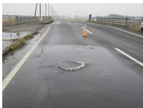
漏水発生状況
