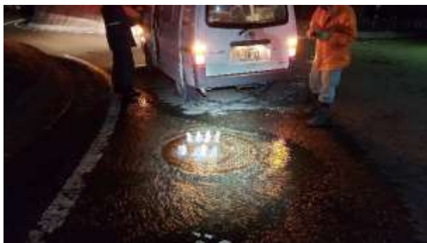
空気弁からの漏水
