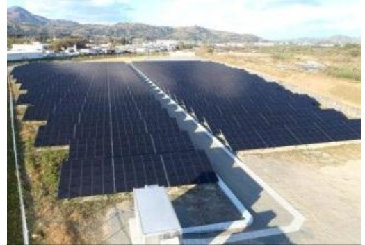
白石太陽光発電所
