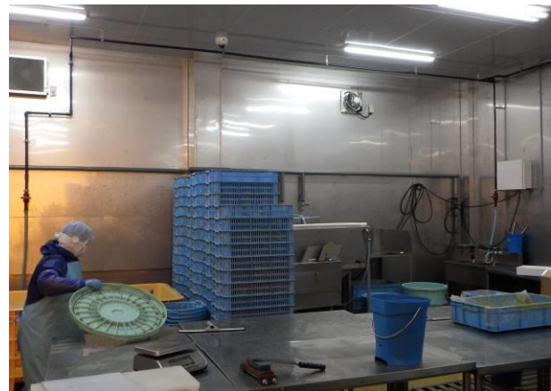
HACCP ハード事業 加工場壁面修繕
