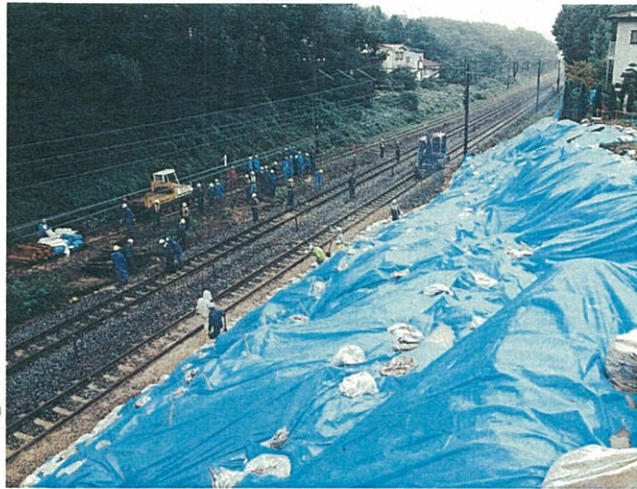
T 4 多賀城市浮島2丁目付近/ 降雨により地盤が弛み、 法面が崩れたJR仙石線
