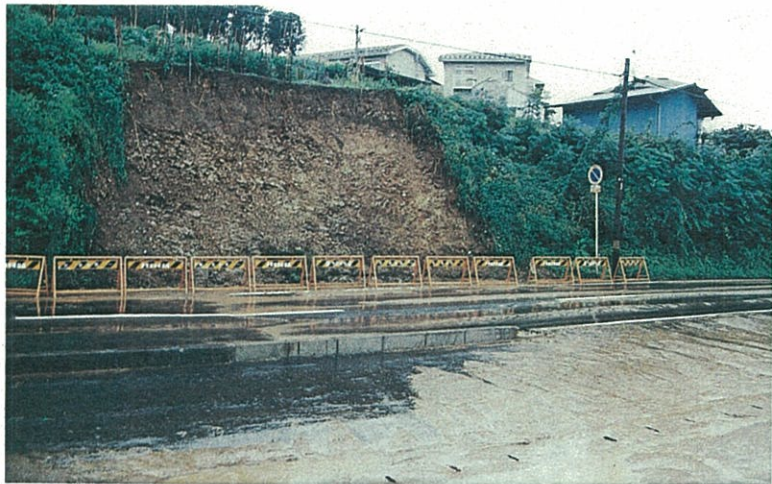
T 5 多賀城市留ヶ谷1丁目留ヶ谷ファミリーマート前/法面が崩れた
