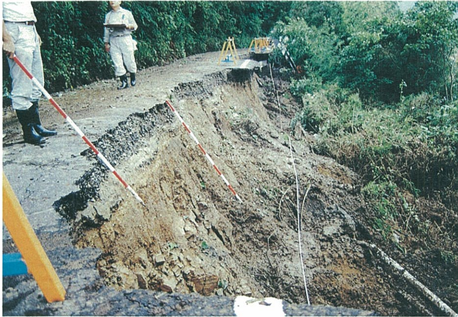
岩沼市志賀地内／土砂崩れにより路肩が崩落(県道岩沼蔵王線)
