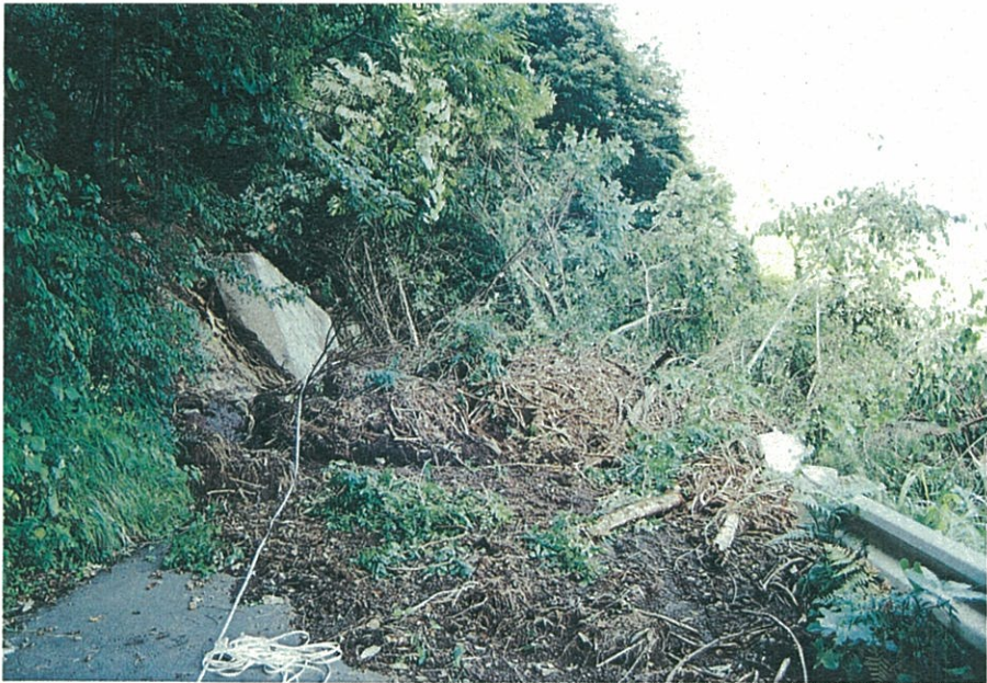
名取市高館川上地内／崖崩れにより分断(県道名取村田線)
