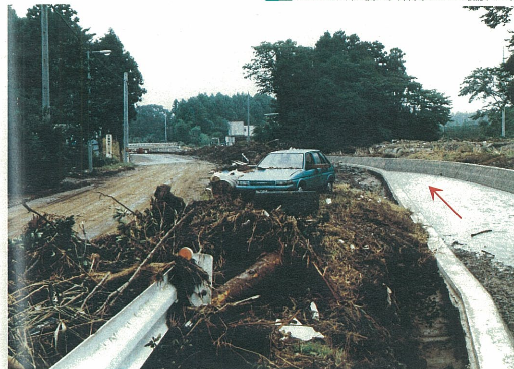
3 河原橋付近／川の増水により倒木などのゴミが散乱している
