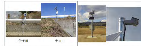
図 2-44 危機管理型水位計および簡易型河川監視カメラ (福島県河川監視カメラ出典：国土交通省)
