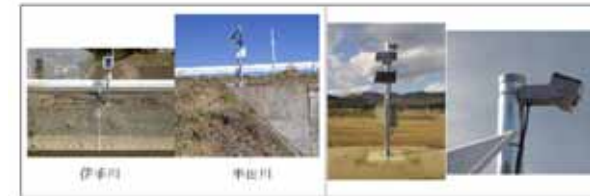
図 2-44 危機管理型水位計および簡易型河川監視カメラ (簡易型河川監視カメラは、国土交通省)
