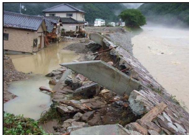
平成21年台風9号による被災状況(兵庫県佐用町)
