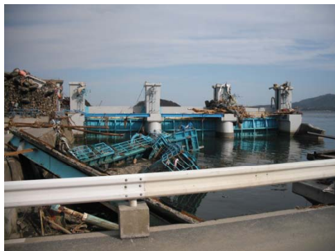
八幡川防潮水門の被災状況(南三陸町)
