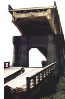
R346錦桜橋の一連が落下
