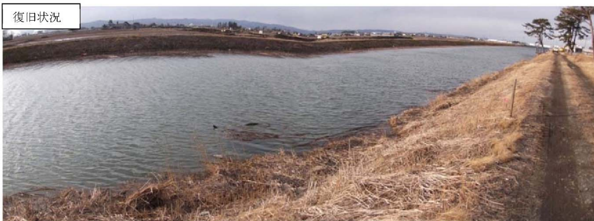
出典：「東日本大震災 1年の記録」(宮城県土木部、平成 24 年 3 月) 五間堀川の被災状況と復旧状況
