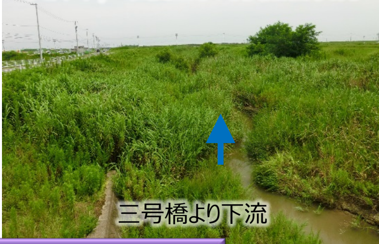
支障木、堆積土砂河積阻害状況
