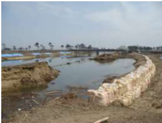
被災した堤防（五間堀川）
