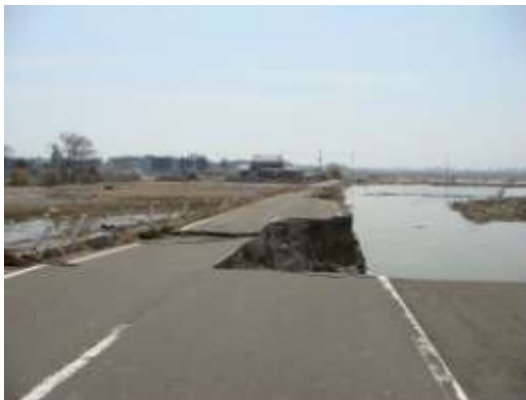
被災した橋梁（五間堀川）
