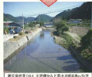
被災後状況(10.9 北沢橋から上流(北沢橋国道45号)方)
