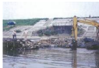
水路確保（引水）状況 旧南郷町（美里町）
