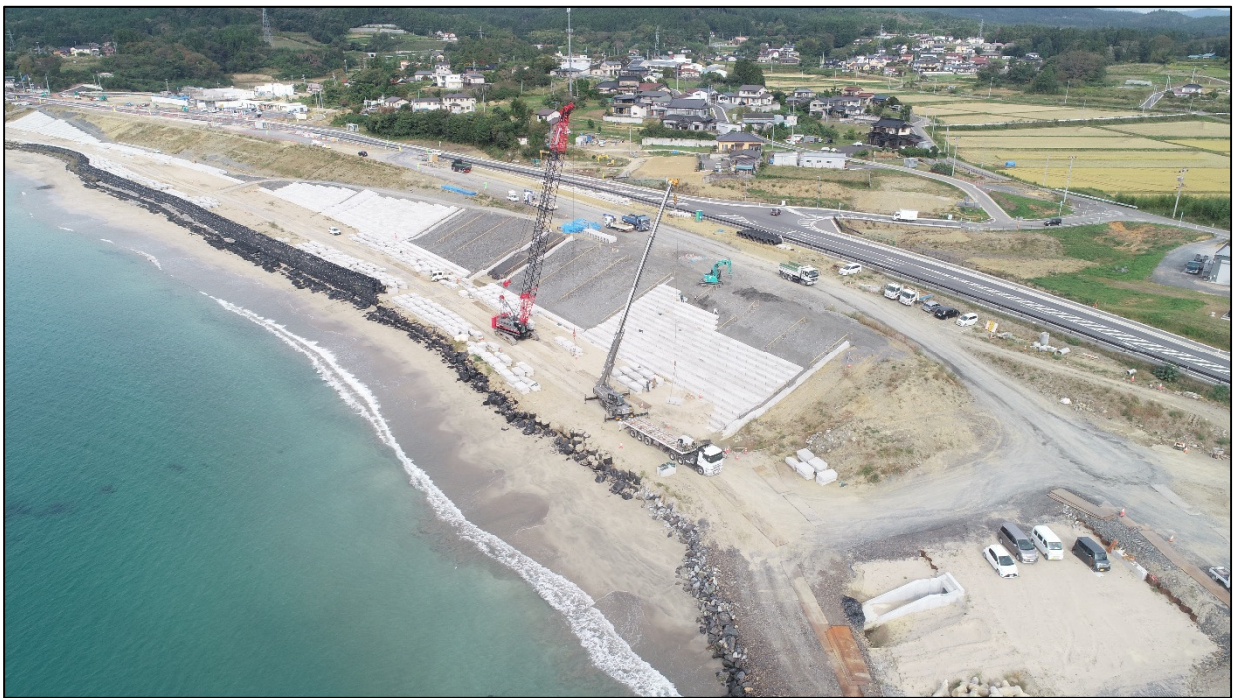
写真 4-4-4 大谷海岸の状況（令和 2 年 10 月）【大谷海岸】
