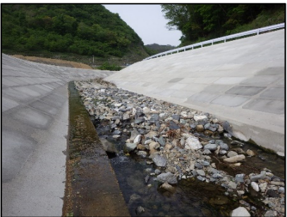
瀬切れ発生状況(低水位時) (令和2年5月15日撮影)
