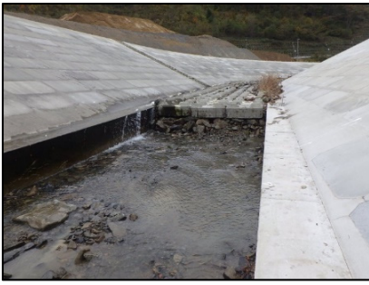
台風により河床工下流の置石が流出し、段差が発生 (令和元年10月14日撮影)
