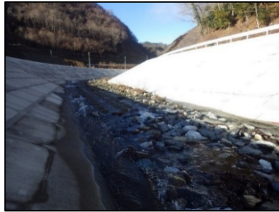
増水時の状況 (令和2年1月30日撮影)
